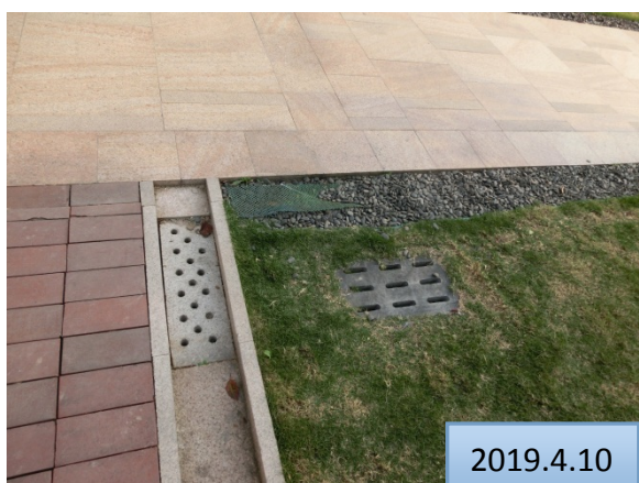
本项目道路旁雨水口
