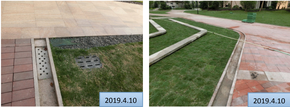
本项目道路旁雨水口
